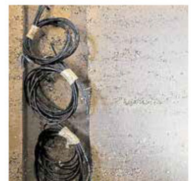
Eine 6 t schwere Wand aus Stampflehm setzt einen Akzent im Wohnraum. Sie lässt sich über diese Heizkabel elektrisch erwärmen.
